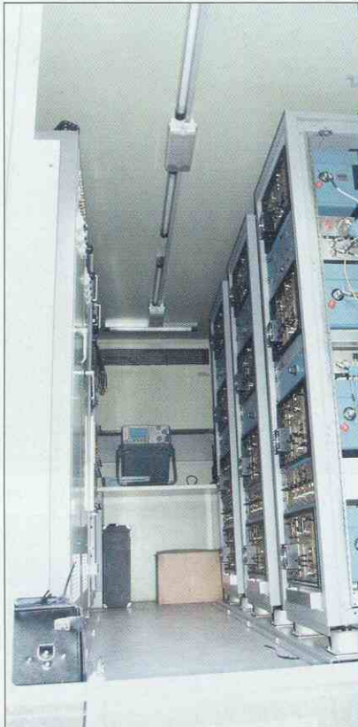
Shelter de comunicaciones (vista del interior).
