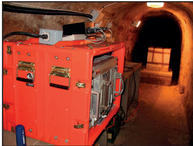
Figura 7: Interior del túnel de la estación sísmica de Banda Ancha MELI.
