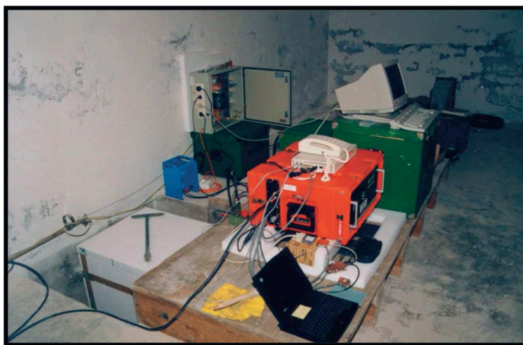
Figura 5: Instrumentación de la estación sísmica de Banda Ancha CART.
