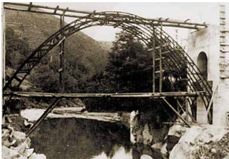
27.- Puente de Viesgo destruido ingenieros Ejército Popular
