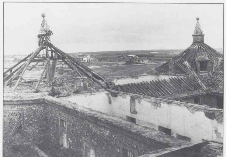
Fotografía 17. Estado del castillo en el momento en que se adquiere para sede del Archivo.
