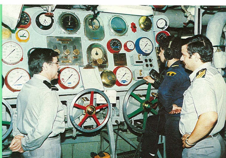
Cámara de máquinas, panel de indicadores y volantes de mandos.
