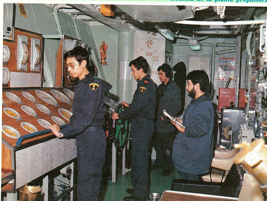
Consola de la planta propulsora.
