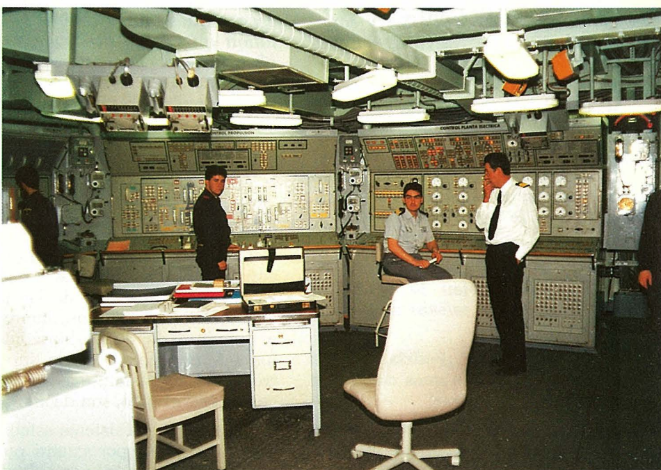
Cámara de control central.
