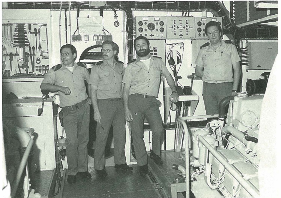
Sala de máquinas y control.
