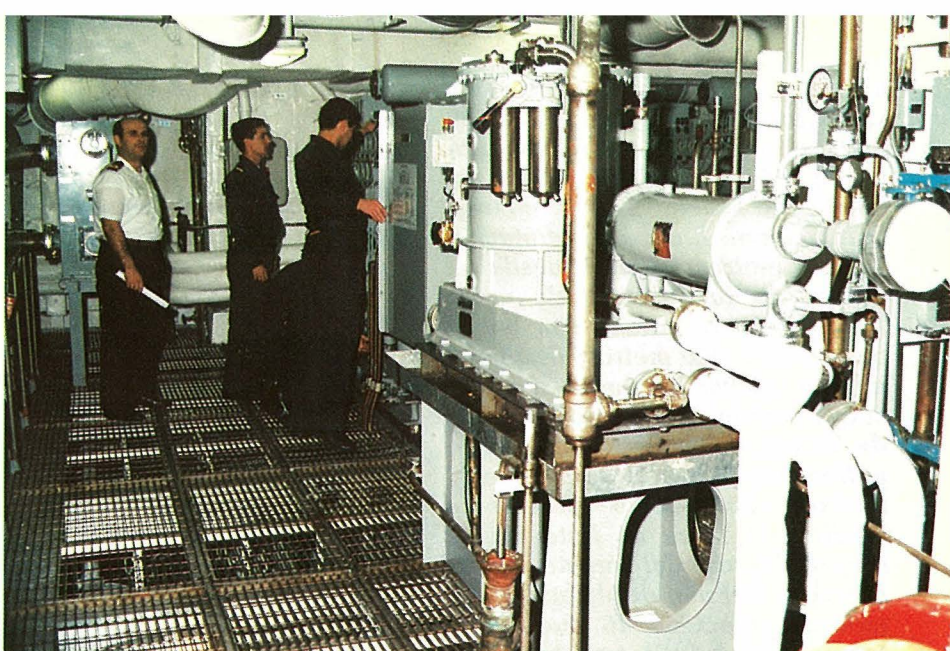
Cámara de máquinas.
