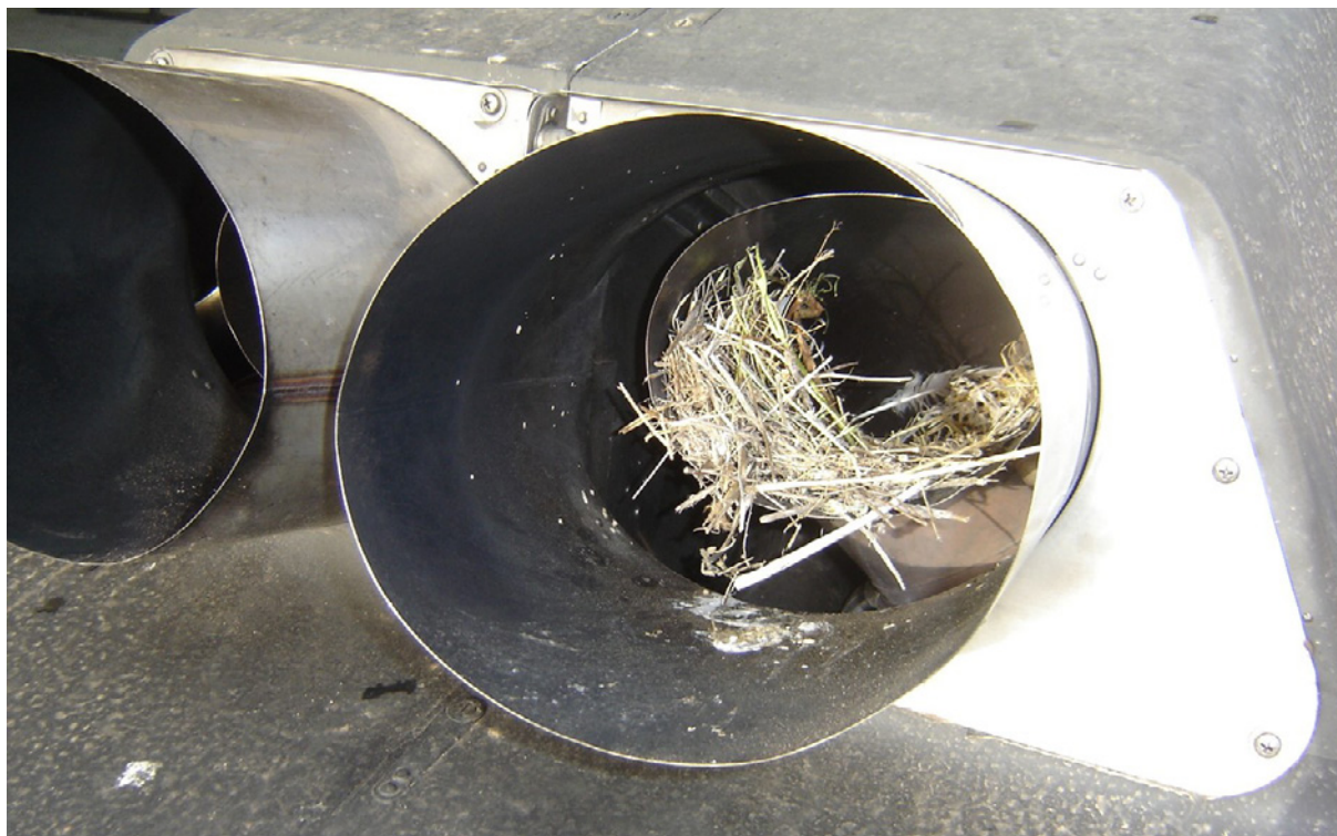
Nido en salida de gases de turbina
