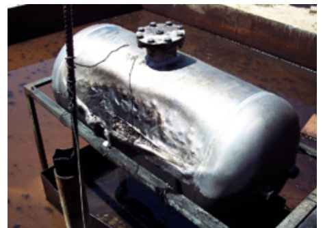
Fig. 7. Estado del depósito que contenía la malla metálica en su interior después de haberlo sometido a llamas directas.
