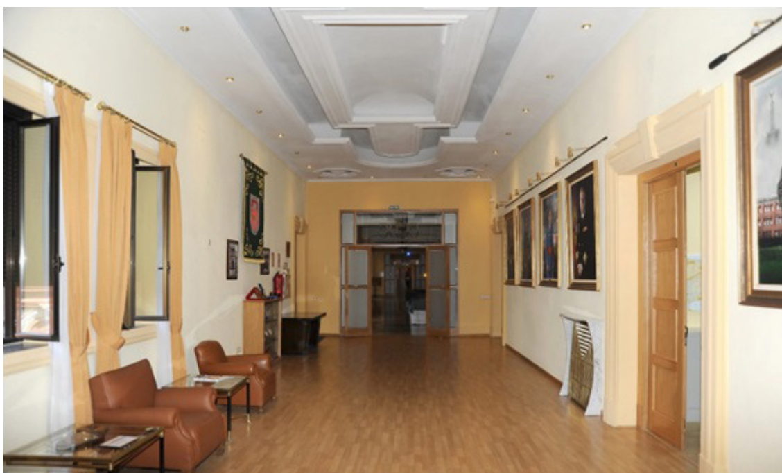
Instalación de nuevas regletas de focos para cuadros de los directores del CESEDEN
