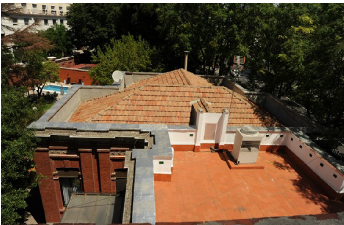
Impermeabilización de cornisas y tejados en el pabellón de cargo del DICESEDEN
