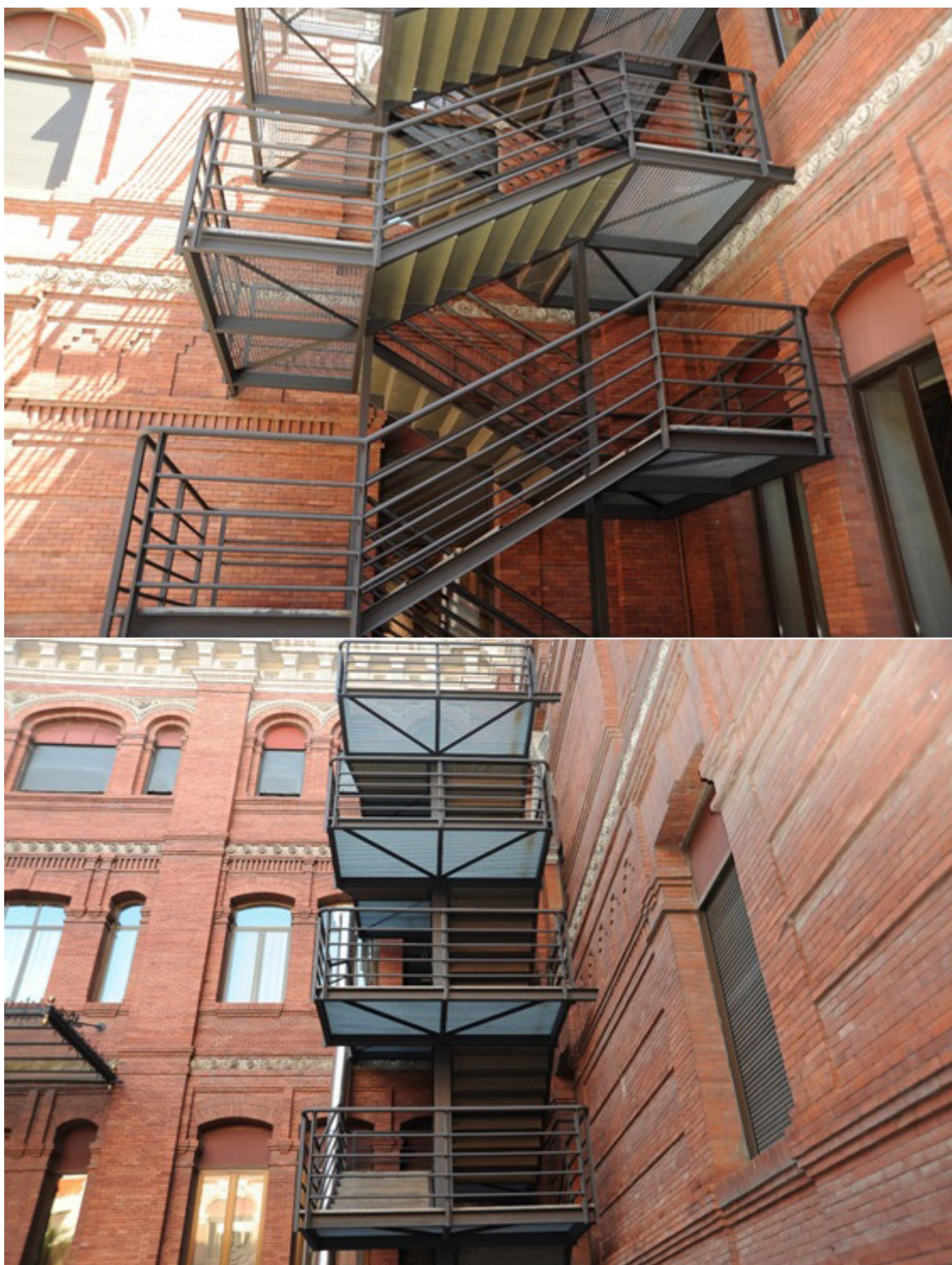
Pintado de las escaleras de emergencia situadas en los patios de Bretón y Zurbano
