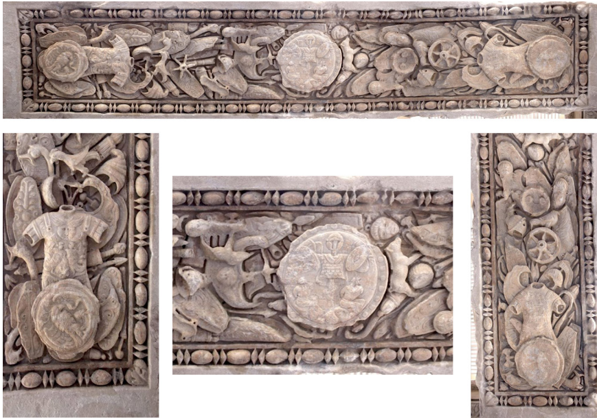
Figs. 8.11, 8.12, 8.13 y 8.14 (conjunto). Los sofitos en su estado actual
