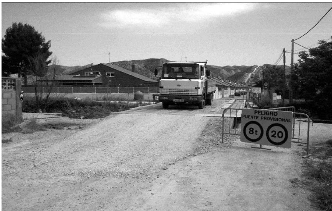
Foto 12. 13 MAY 03. Puente finalizado. Detalle de la señalización colocada y de la rampa de tierra.
