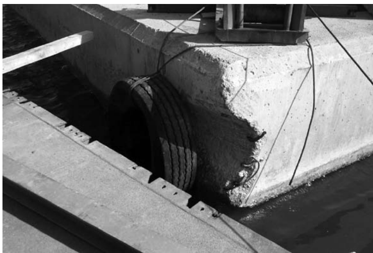
Foto 13. 18 ABR 04. FÓRUM-04. Detalle del destrozo causado por el pontón 18-E en el muelle.
