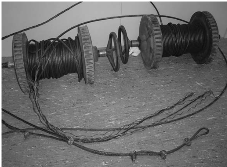
Foto 12. 17 ABR 04. FÓRUM-04. Detalle de los cables de acero, partidos.
