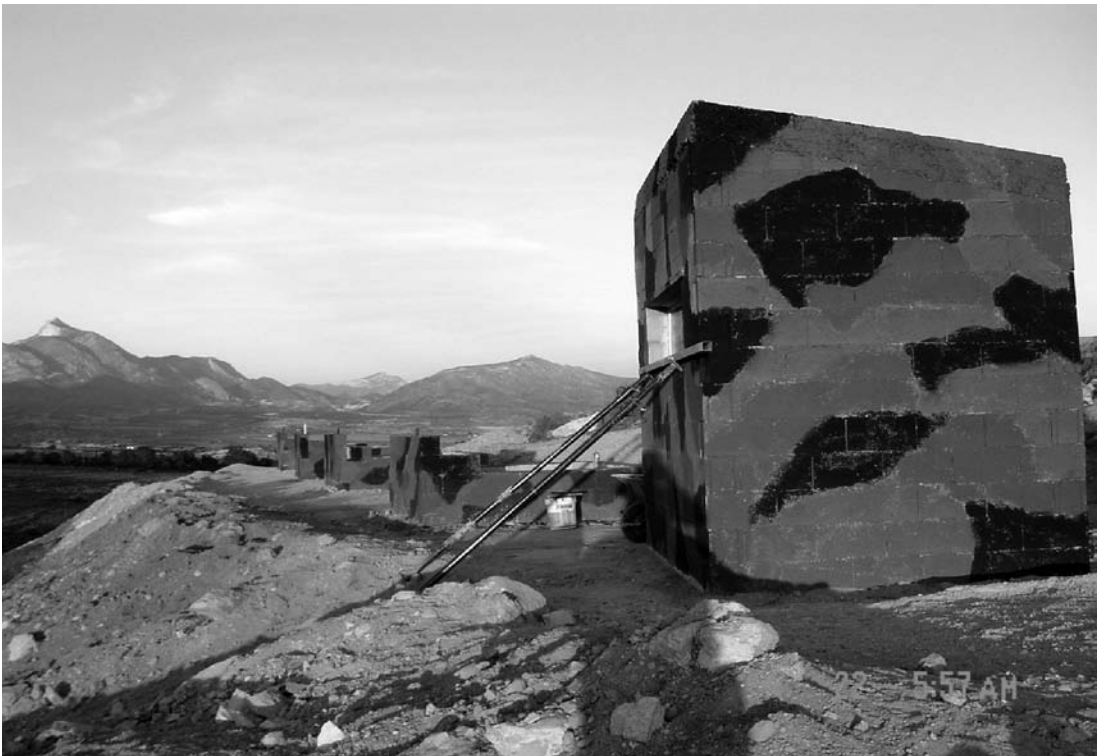
Instalación eléctrica, asentamientos AMM y caseta de control
