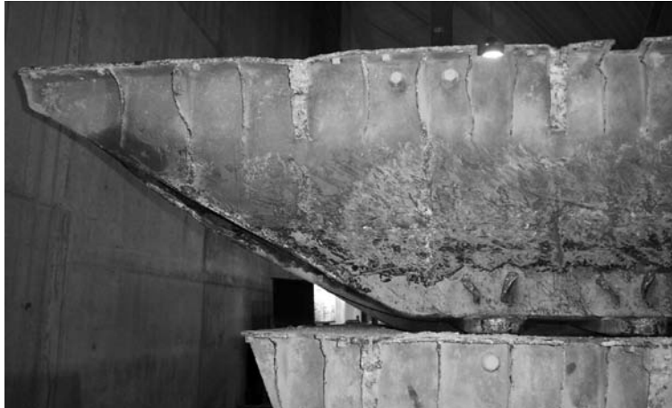
Foto 14. 18 ABR 04. FÓRUM-04. Detalle de los daños sufridos por el pontón 18-E.
