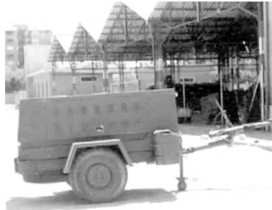
Grupo electrógeno DESOSTRAL 15 KVA Tipo «B».
