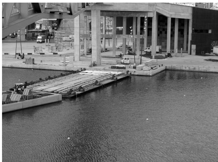
Foto 17. 28 ABR 04. FÓRUM-04. Detalle de la colocación del tablero de madera por la empresa NUSSLY. Las boyas de señalización amarillas, indican la existencia de un cuerpo muerto.
