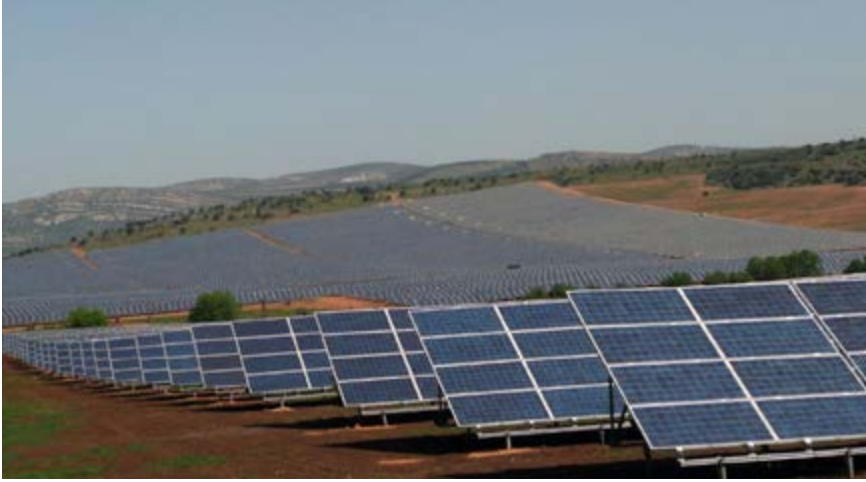
Foto 6. Instalación solar convencional montada sobre suelo rústico.
