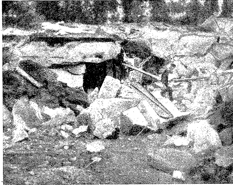
Efectos de una bomba pesada sobre una casamata de cemento, cuyo espesor se aprecia perfectamente en la foto.
