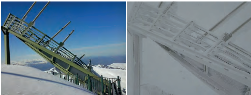
Consecuencias del mal tiempo: puente de antenas deformado por la acción del viento huracanado y la carga de hielo
