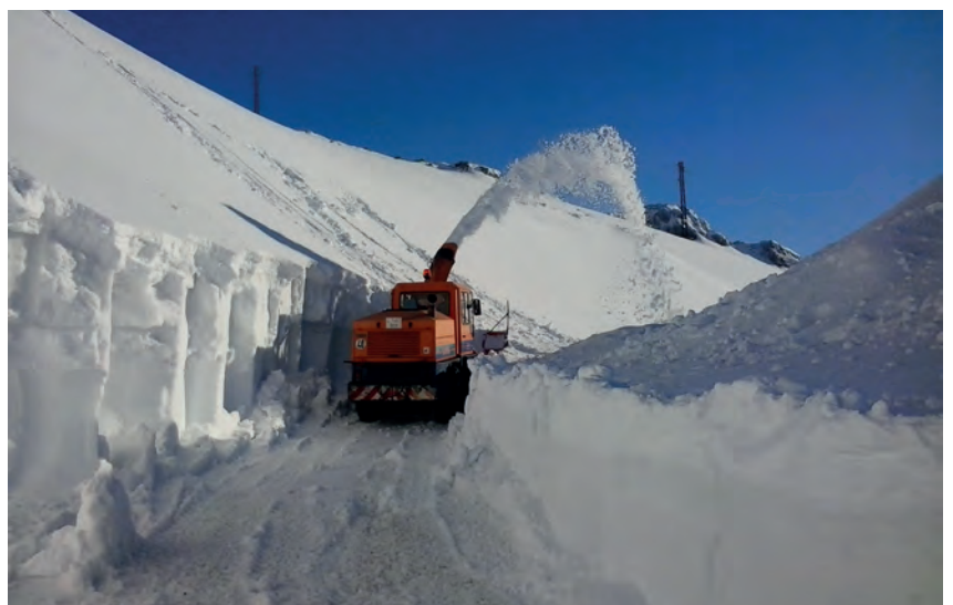
Vial de acceso a la unidad tras varios días de trabajos de limpieza. Obsérvense los espesores de hielo y nieve, variables de tres a doce metros con un promedio de seis metros
