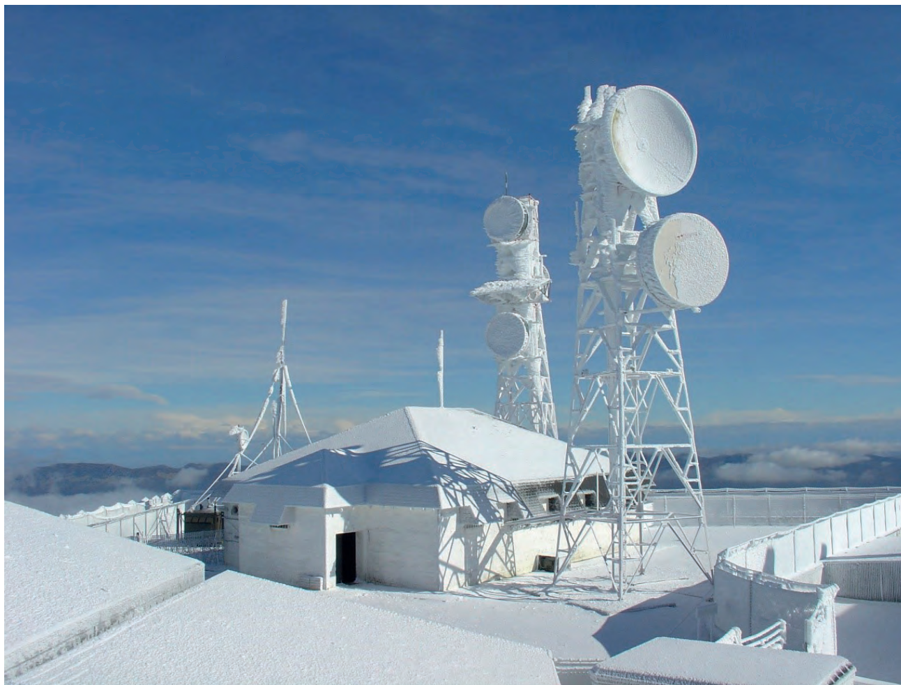
Mantenimiento de la estación RCT-170 Guadalupe en condiciones adversas
