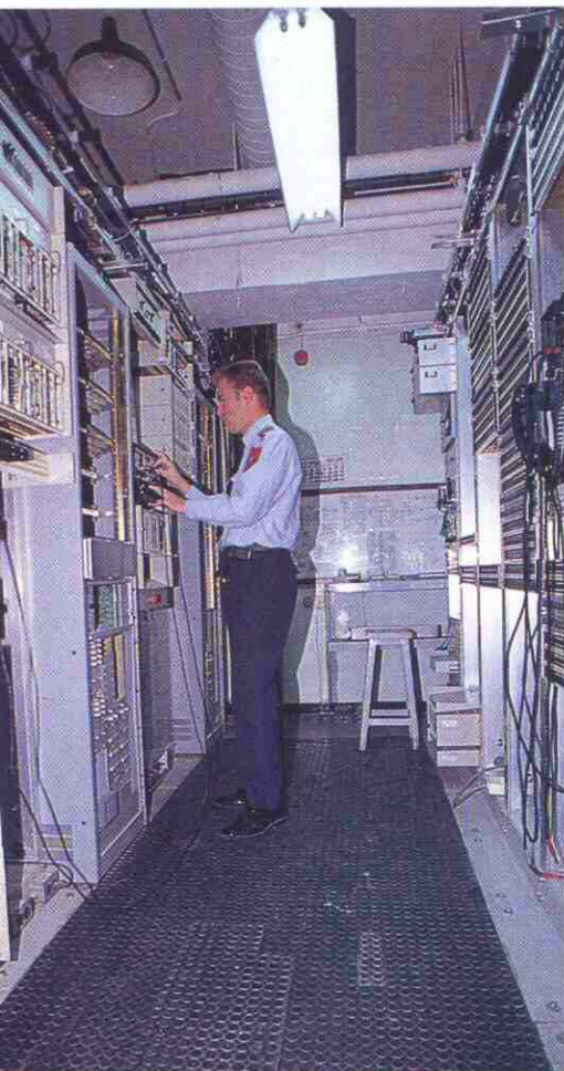
Apoyo. Los técnicos de mantenimiento cuidan del buen estado de las instalaciones.
