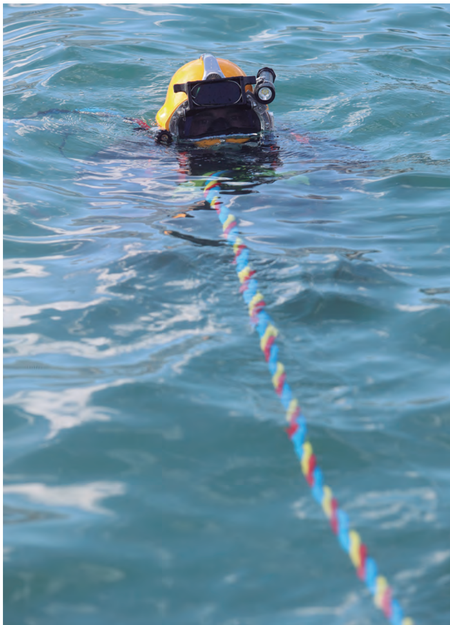
El buzo, en el agua, con los cables que unen el casco y la embarcación y que garantizan la seguridad en las inmersiones.
