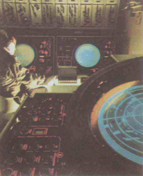
Consolas de la central de control de la batería (BCC).
