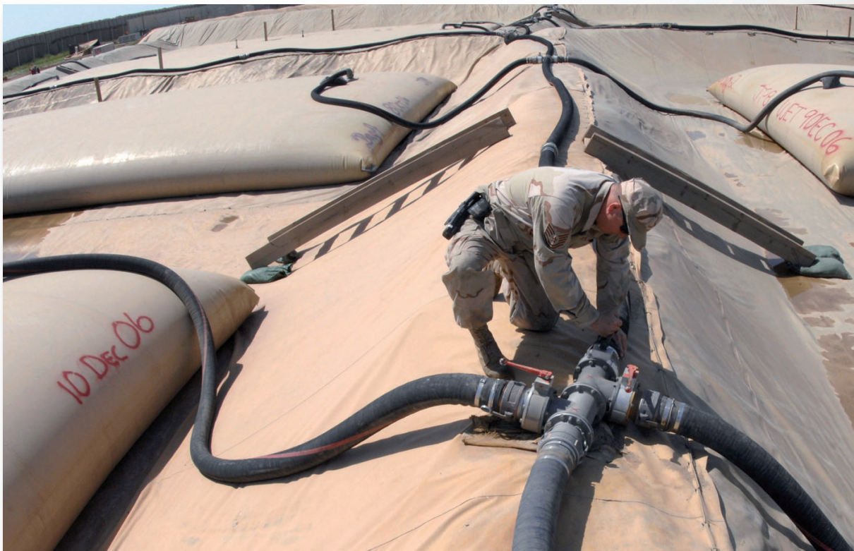
Almacenamiento de combustible en bladders
