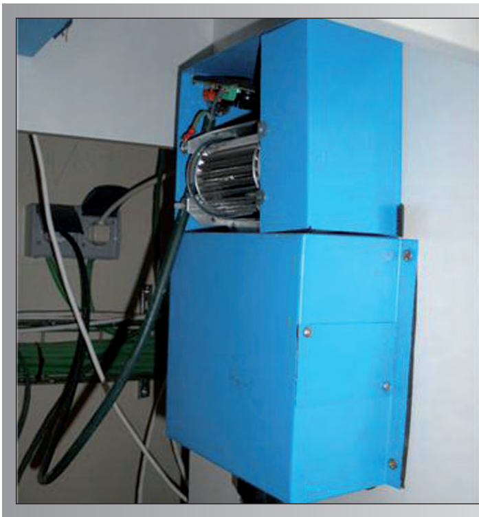
Motor de impulsión de aire. Todas las vitrinas cerradas cuentan con un sistema de renovación de aire. De esta forma se pretende equiparar la climatización controlada de la sala con la del interior del espacio expositivo
