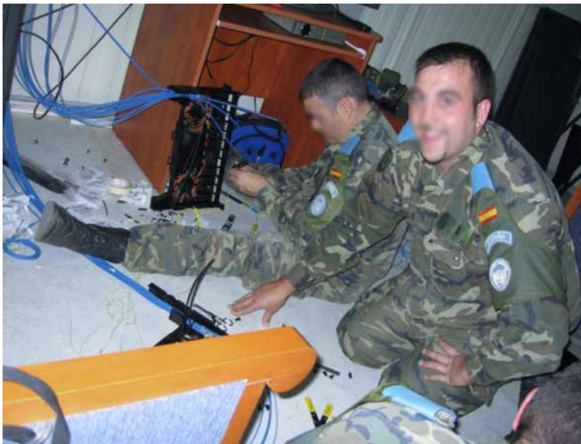
Tendidos de cableado «backbone» en la Base Miguel de Cervantes (Marjayoun, el Líbano)
