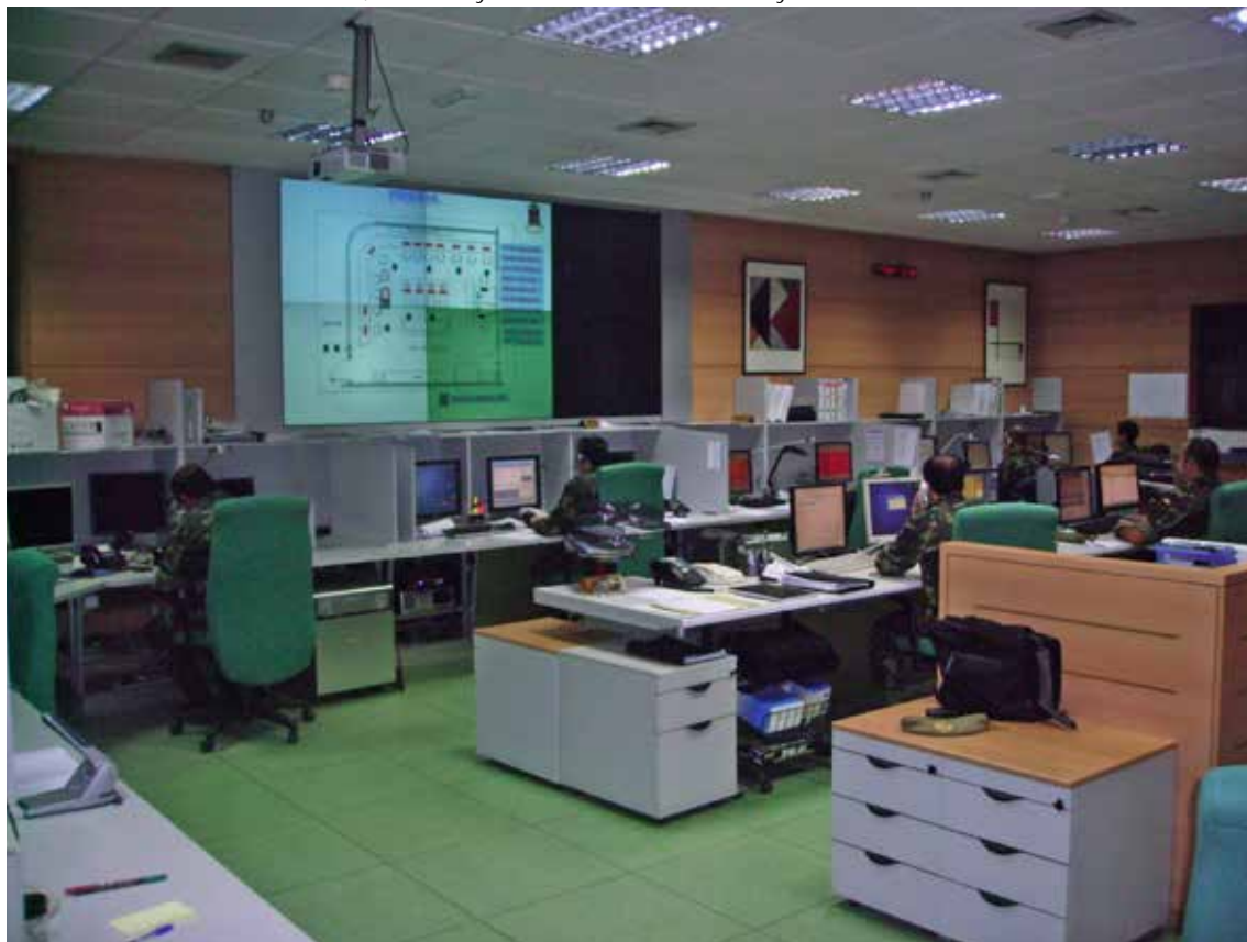
Centros de control de las redes, sistemas y servicios de información y telecomunicaciones
