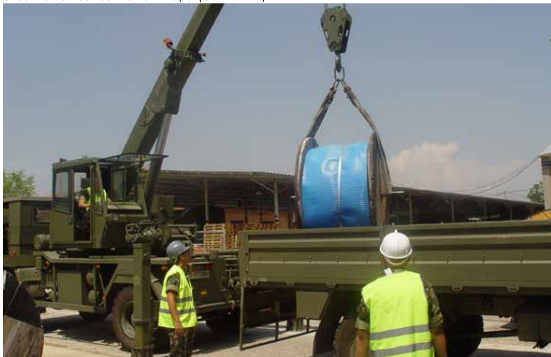
Carga de bobinas en el Almacén General de Distribución perteneciente al Centro de Abastecimiento Principal (CABASPRAL)
