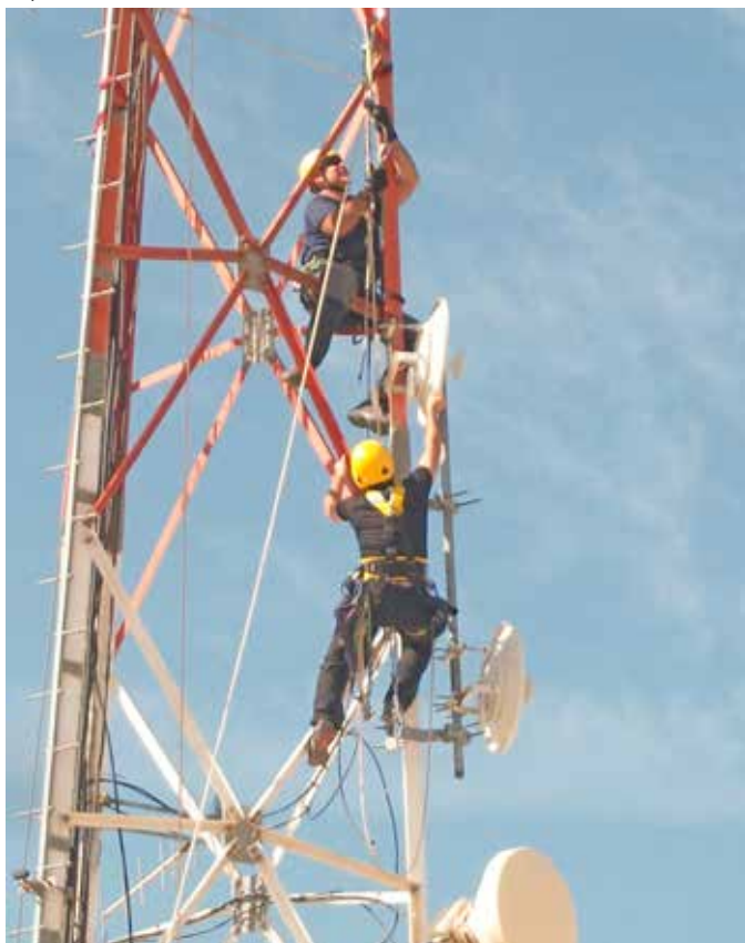
Instalación del sistema de radioenlaces permanentes (operación L/H, el Líbano)
