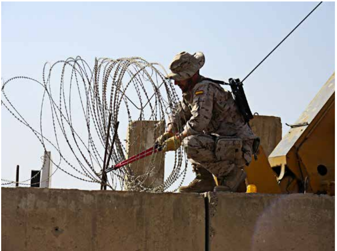
Disponer de una unidad de Ingenieros, proporciona la flexibilidad necesaria para acometer múltiples tareas
