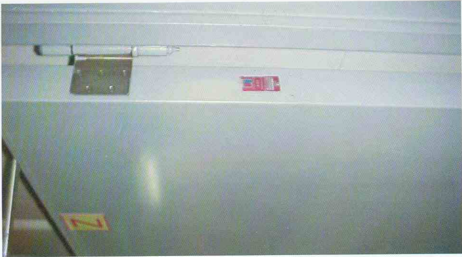
Puerta A-60 con placa identificativa (integridad al fuego).
