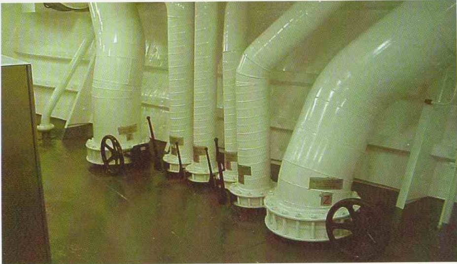
Válvulas antihumos (sistemas de ventilación).
