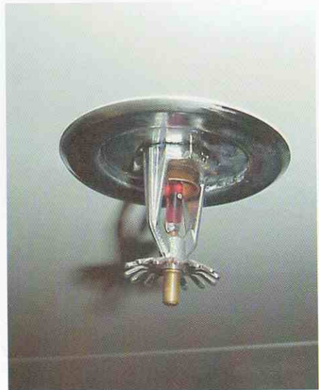
Rociador en sollados (rociado automático).
