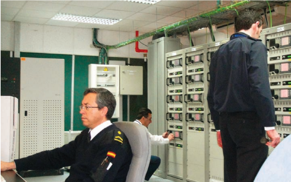
Sala de Receptores en Bermeja.
