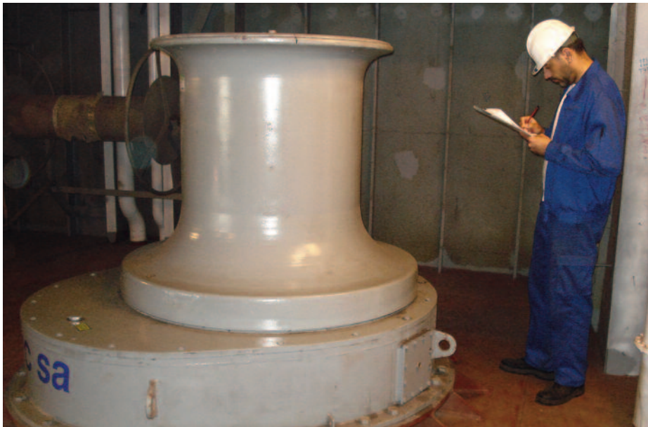
Ingeniero de la ICOFER inspeccionando la estación central de amarre a bordo del Juan Carlos I en Ferrol en 2008.
