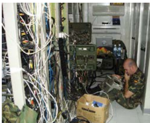
Centro de comunicaciones
